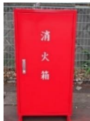
初期消火箱（固定式）
